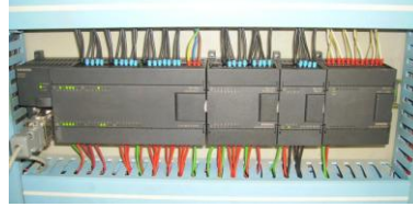
SIEMENS S7-200 PLC
